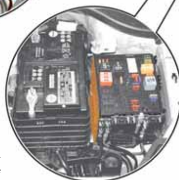
Дополнительный кронштейн реле, под блоком предохранителей и реле
